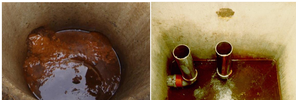
Figuur 14: Voorbeeld van een met ijzer verstopt drainagesysteem dat niet wordt onderhouden (links) en een onderhouden systeem (rechts)
