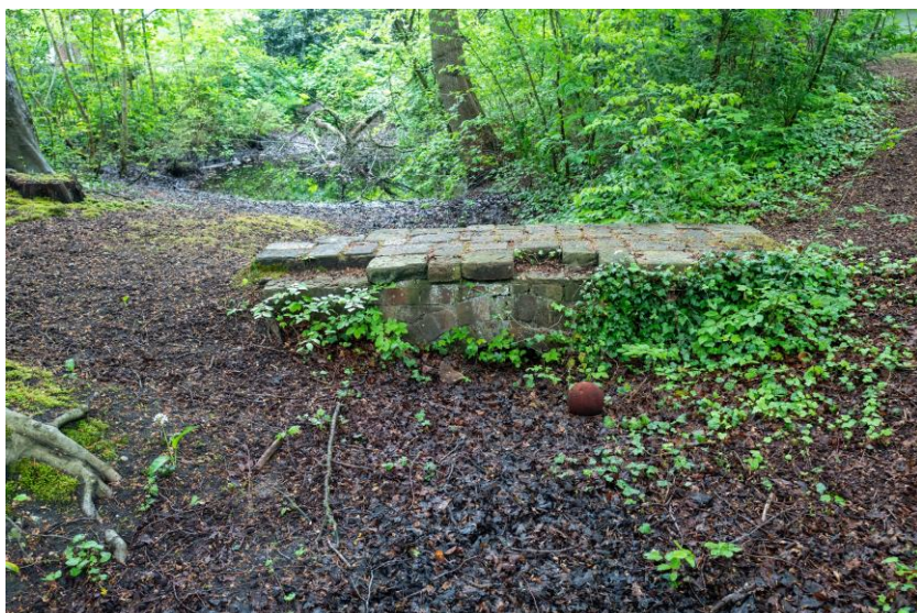
Figuur 22. Vervallen stenen bruggetje over een volledig dichtgeslibde duinrel op de Tijo van Eeghenschool in Aerdenhout.
